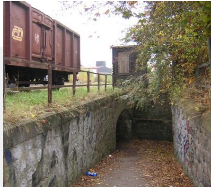
nevyhovující podchod pod tratí
